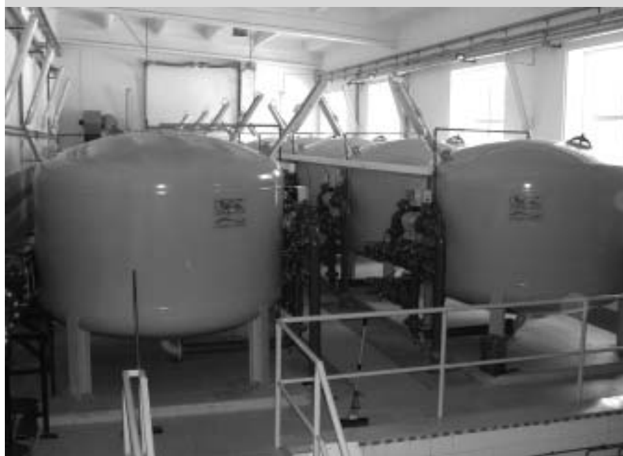
Filtry Culligana — Ujęcie Wody „Krzywe Błota”
